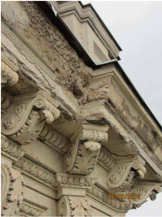
< massive Putzschäden am Hauptgesimse an der SW-Ecke
