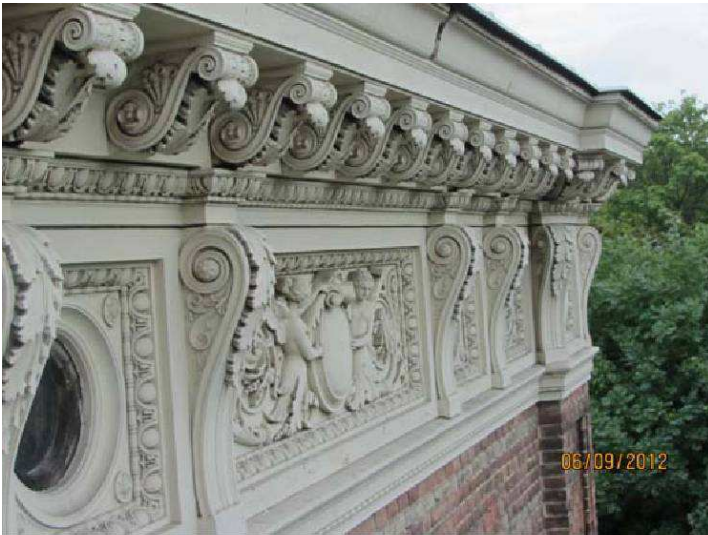
< Ansicht auf Hauptgesimse; rechte Gebäudeecke vor den Restaurierungsmaßnahmen
