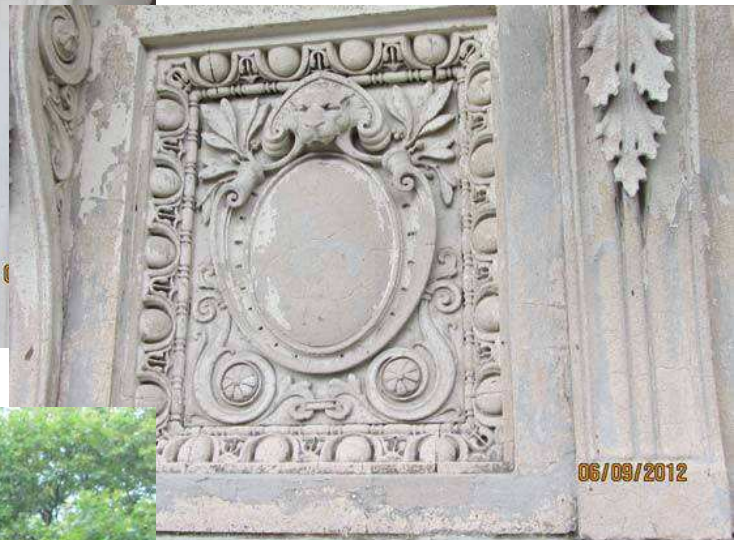
^ Fries: rezente und schadhafte Verkittungen mit Grauzement
