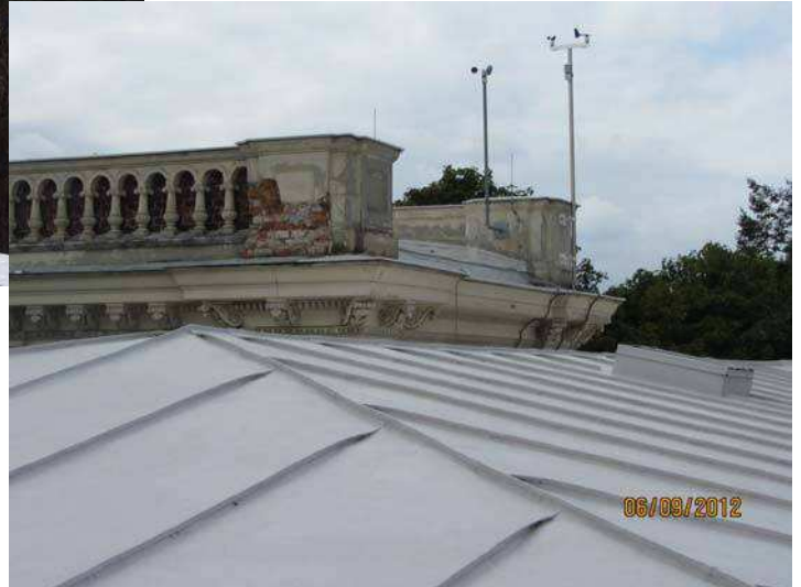
^ Attika mit stark beschädigten Eckpfeilern < fehlende und beschädigte Baluster im Attikabereich
