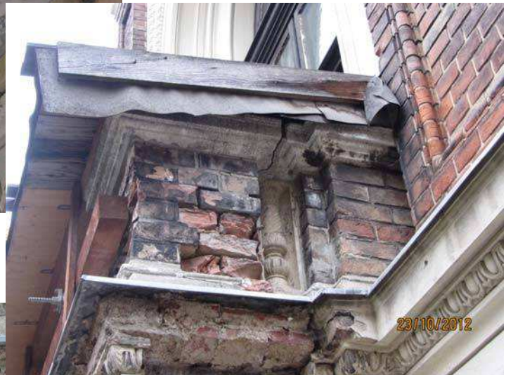
Der südseitige Turmbalkon wurde in weiterer Folge einer kompletten statischen Sanierung unterzogen
