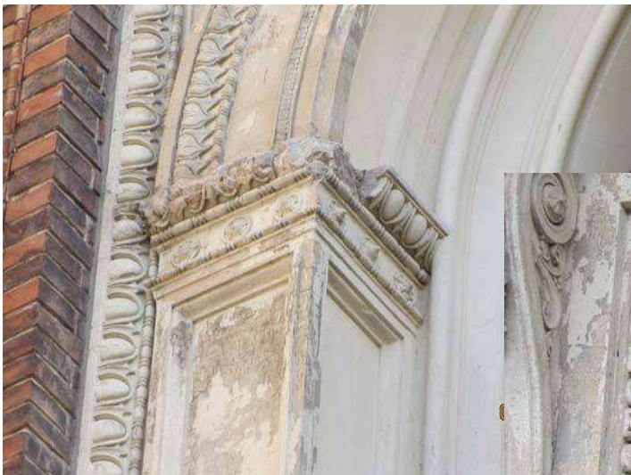
< Fensterumrahmung: beschädigtes Kapitell
