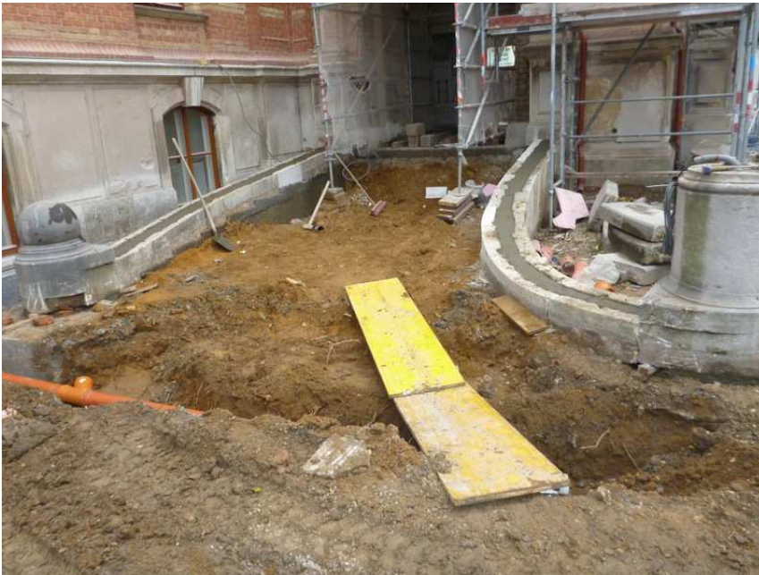
< Ansicht auf wieder hergestellte Einfassung (noch ohne Abdeckung), sowie Erdarbeiten im Bereich der Auffahrt
