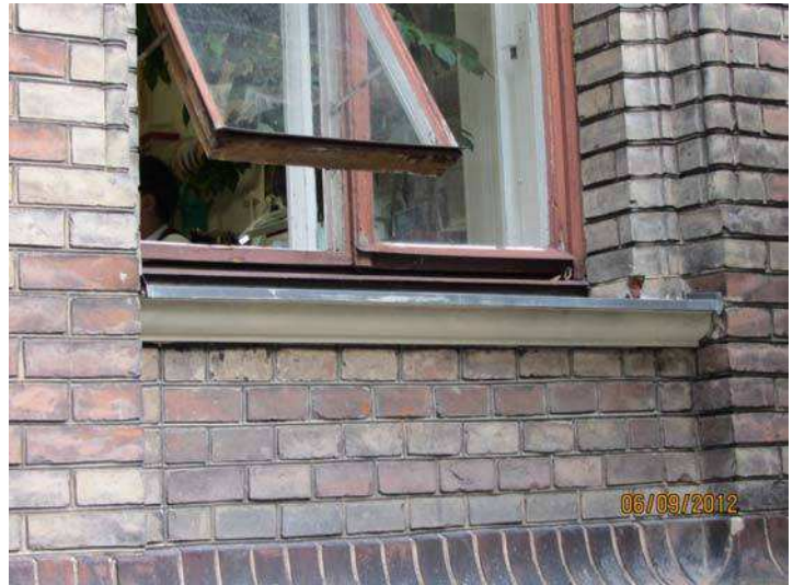
Sichtziegelmauerwerk_Parapet EG teils beschädigte Mauerwerksziegel
